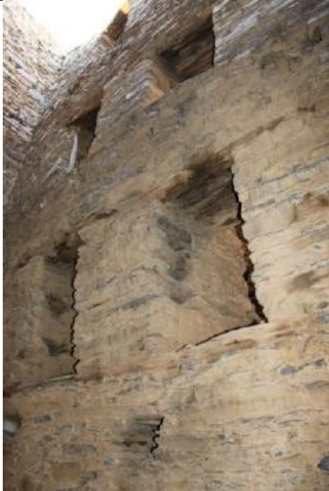
لوحة (٨) أطم (حصن) الكلادا الجنوبي: مداخل الوحدات الداخلية بعد تهدم السقف.
